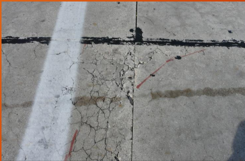
Καταπόνηση οδοστρώματος από σκυρόδεμα
