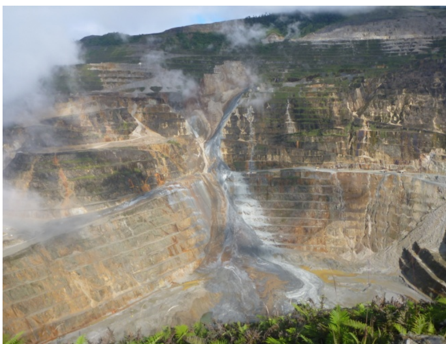
Αστοχία πρανών του ορυχείου χρυσού OkTedi στην Παπούα Νέα Γουινέα (Bar et al., 2016)
